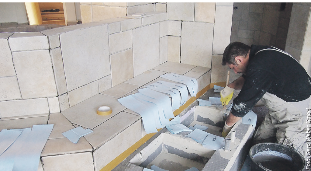
Probleme in Wellnessanlagen gehören zu den täglichen Herausforderungen für die Gerd Weber GmbH. Das Foto entstand in einem Saunatrakt.
