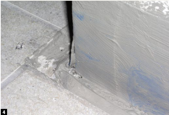
4 Unsachgemäße Eindichtung ohne Formteile (90°-Außenecke)
