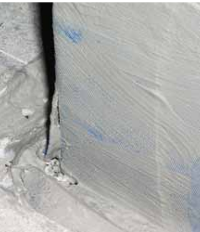
Unsachgemäße Eindichtung ohne Formteile (90°-Außenecke).
