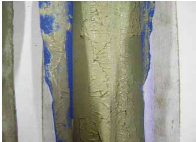
Nicht ausgehärtete Dispersionsabdichtung nach 7 Tagen unterhalb der Elastomere-Bänder.
